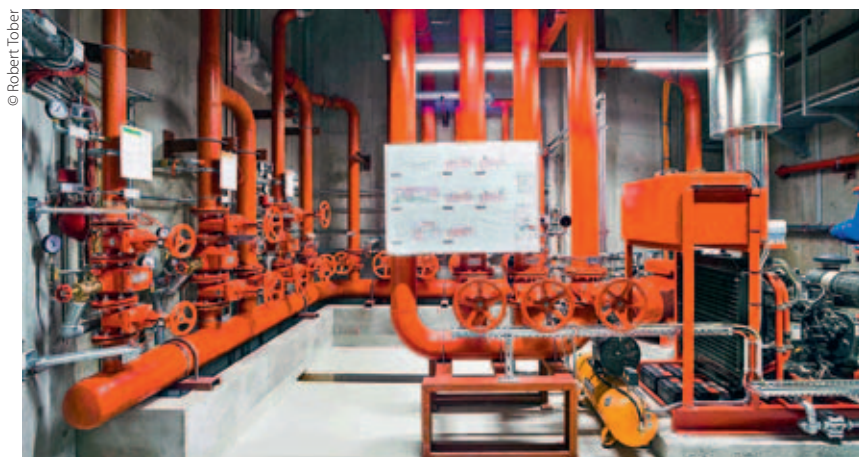
Sprinklerzentrale Hörsaalzentrum: Versorgung verschiedener Gebäude über eine gemeinsame Sprinkleranlage.
