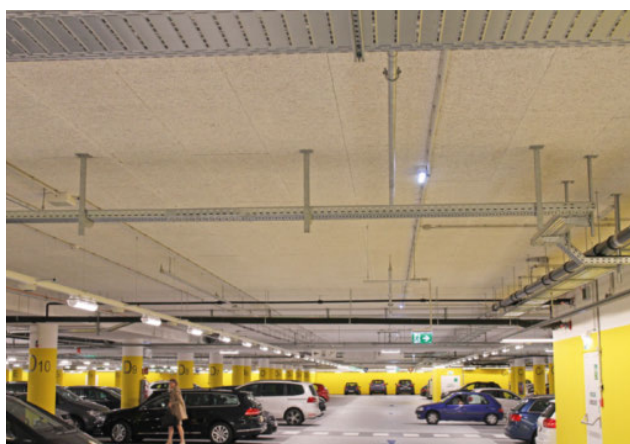
Holzwole-Leichtbauplatten mit Steinwollekern an der Garagendecke.
